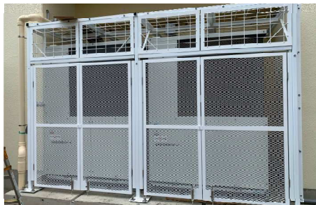
■ 室外機ガードフェンス
